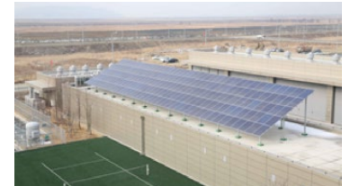
인천 제2격납고 태양광 발전 설비
