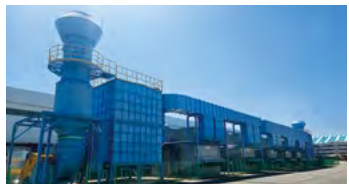
Back shop 도장시설 대기방지시설
