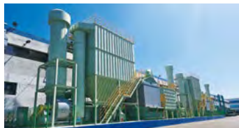
조립1공장 외부 대기방지시설 전경
