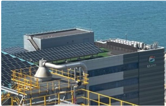
GS칼텍스 여수공장 사무동 태양광 발전시설
